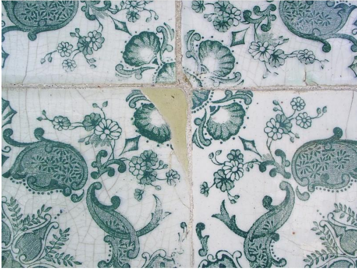
Amarelecimento da resina de preenchimento
