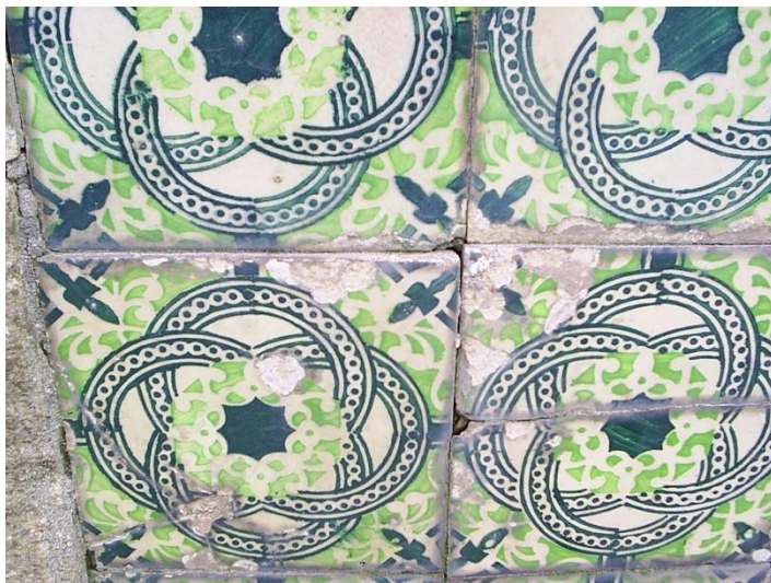
Concreções e fractura
