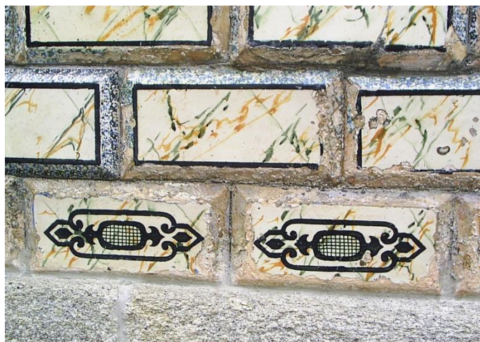
Resina de consolidação que criou um filme devido à rápida evaporação do solvente. Apresenta sujidades e destacamentos
