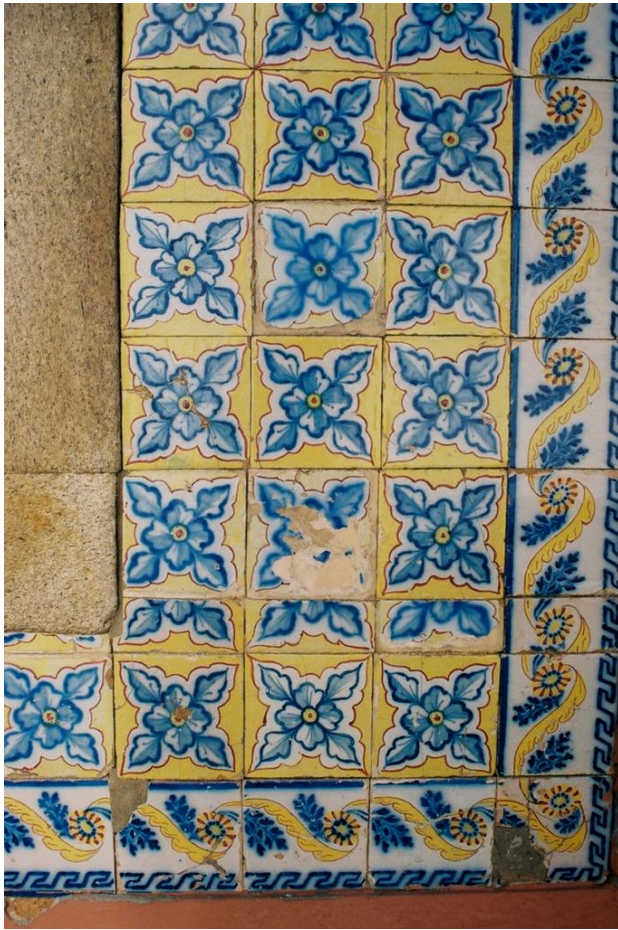
Painel com lacunas de vidro extensas e preenchimentos com cimento
