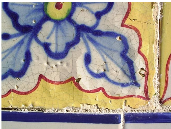
Destacamento e empolamento de vidrado e efflorescências
