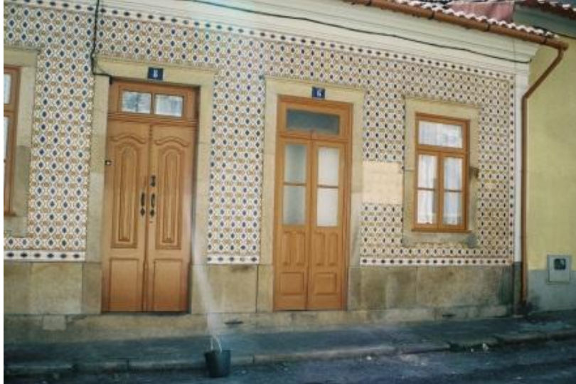
Aspecto geral da fachada após os azulejos terem caído e antes de se iniciar a intervenção
