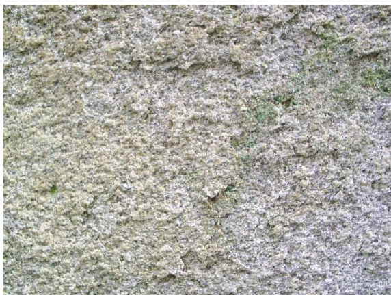
Degradação do granito
