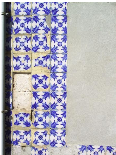
Lacunas de azulejos, preenchimentos com cimento e lacunas de vidro
