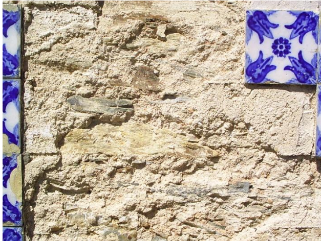
Aspecto de uma lacuna de azulejos onde se vê destacamento da argamassa de emboço do suporte
