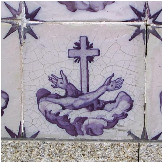
Fissuração generalizada de vidro
