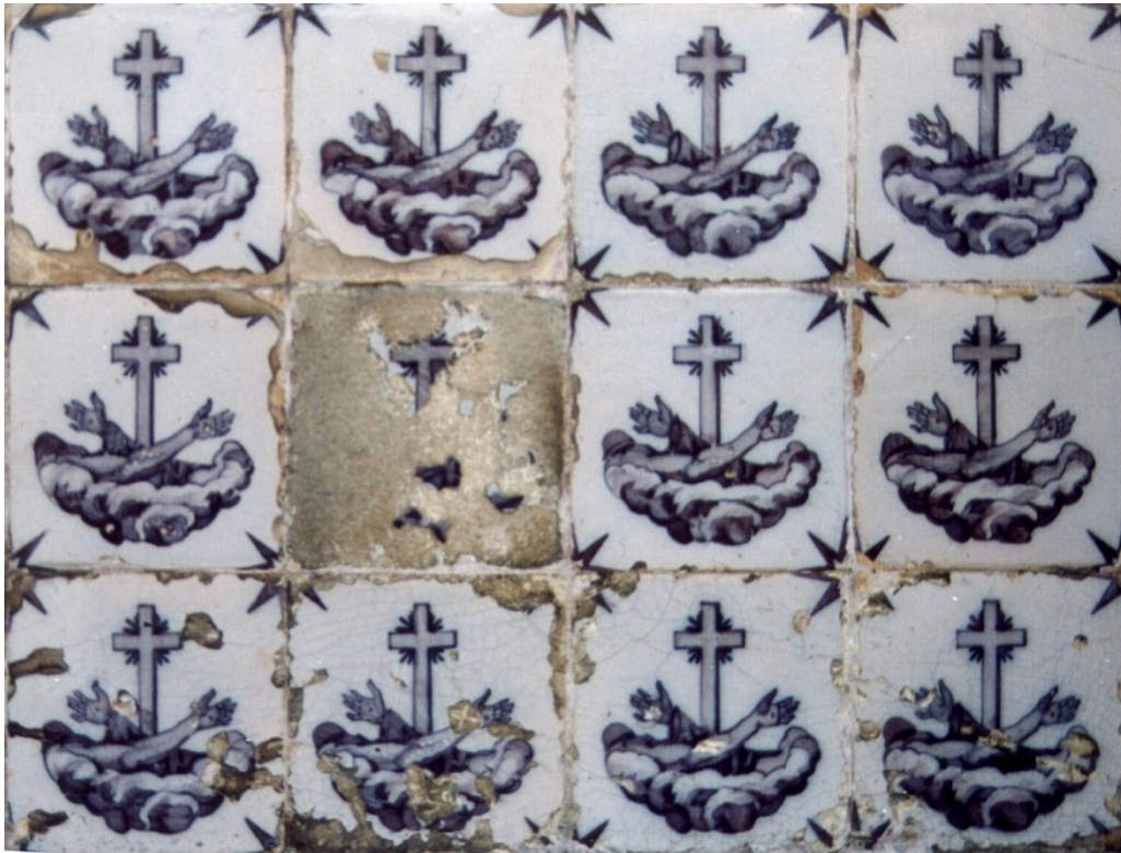
Aspecto geral de um pequeno painel antes da intervenção. Lacunas de vidro de diferentes extensões.
