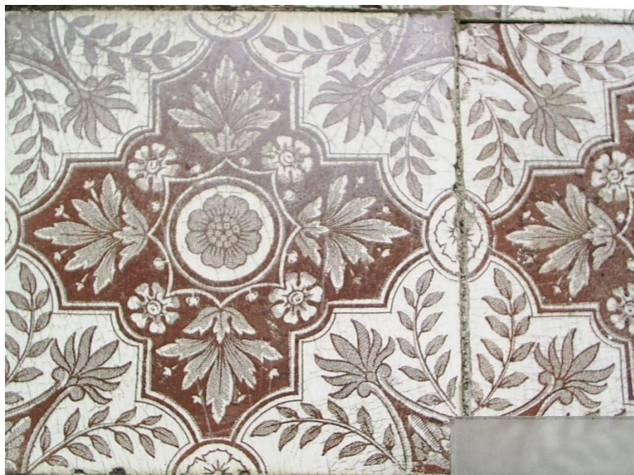
Desvitrificação e fissuração generalizada de vidro
