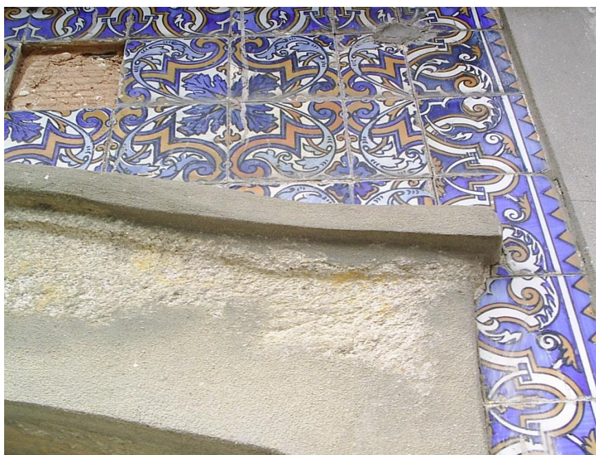
Lacuna de azulejo, preenchimentos com cimento e concreções sobre os vidrados.
