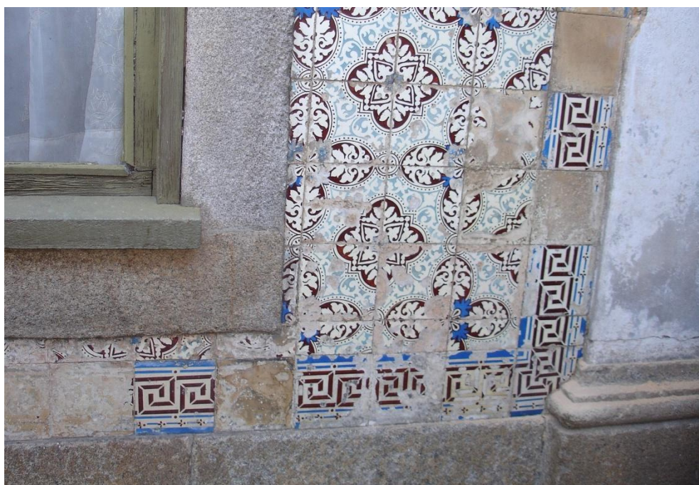
Aspecto de um dos painéis da fachada com extensas lacunas de vidro
